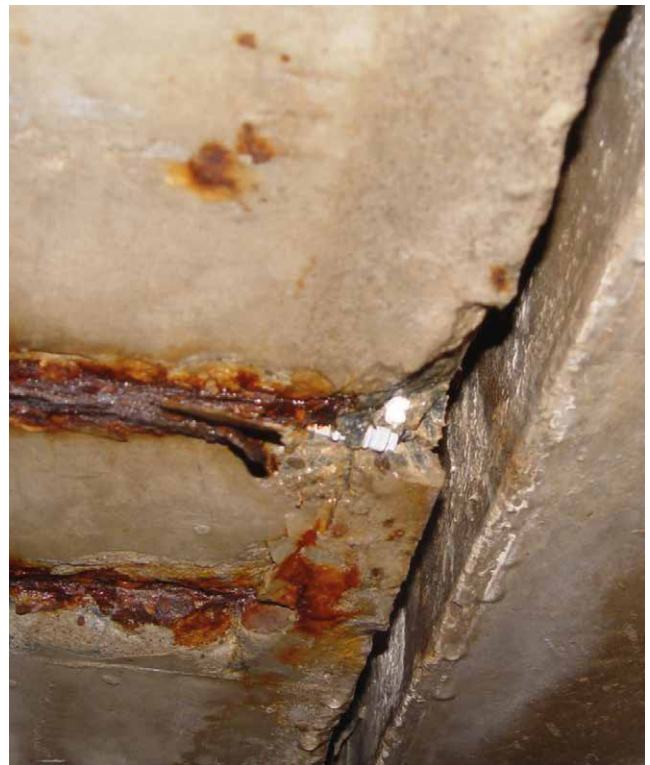
Der Bewehrungsstahl ist stark durch Milchsäure und andere Stoffe korrodiert und kann die Standsicherheit nicht mehr gewährleisten.
